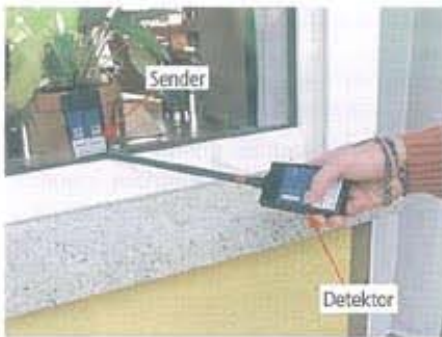
Bild 4: Hier werden Undichtigkeiten am Fenster gesucht. Der Sender befindet sich innen, am Ende des Verlängerungsrohrs.
